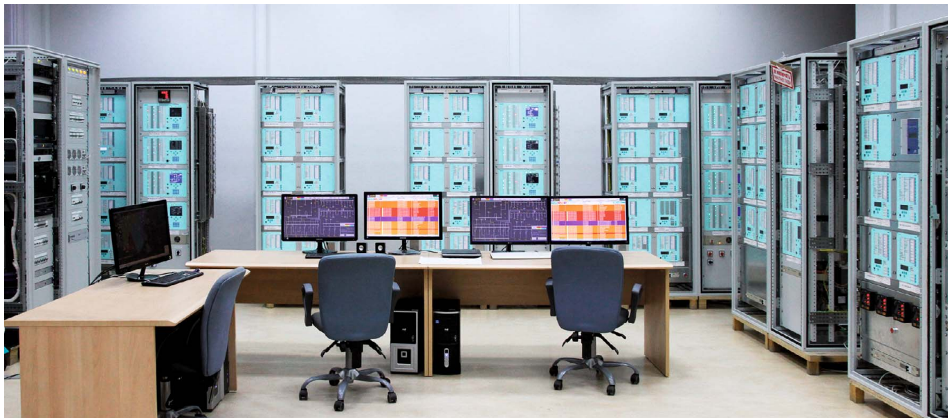
Полигон АСУ ТП
