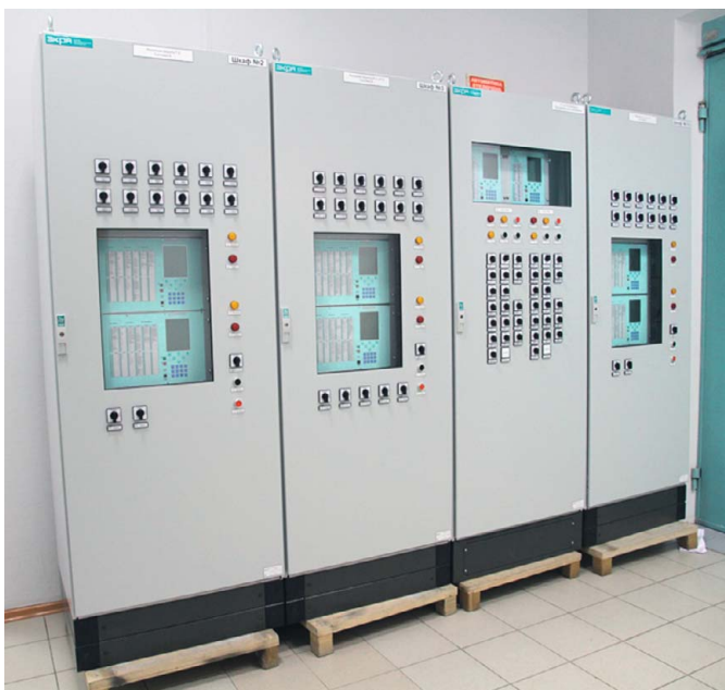
Шкафы РЗА станционного оборудования
