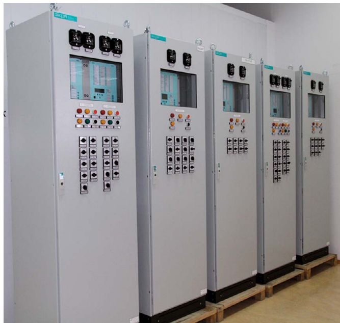
Шкафы РЗА подстанционного оборудования
