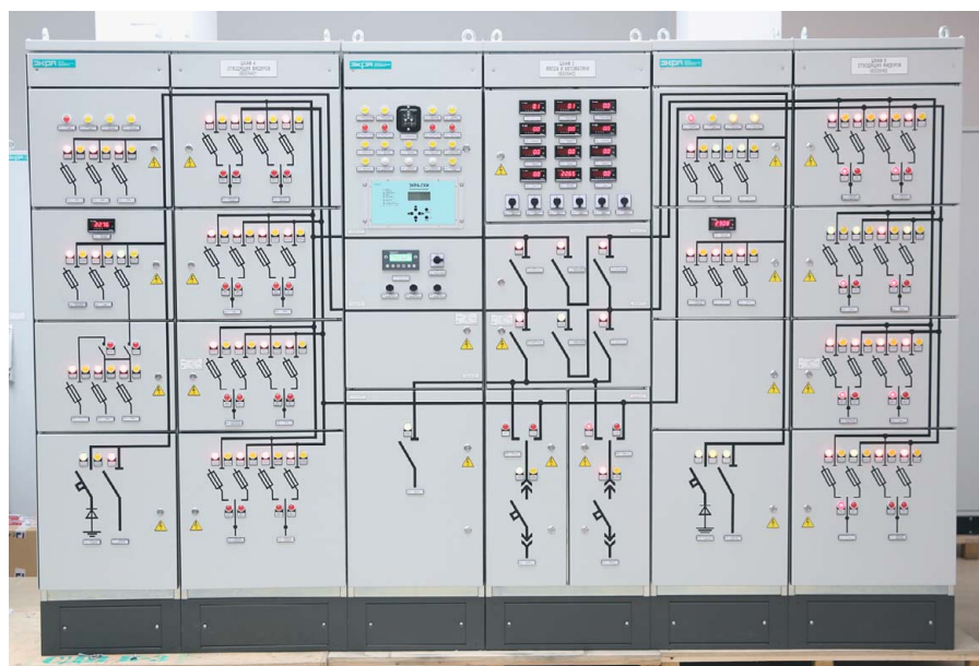
ER5A2296. Щит постоянного тока на Балаковской АЭС
