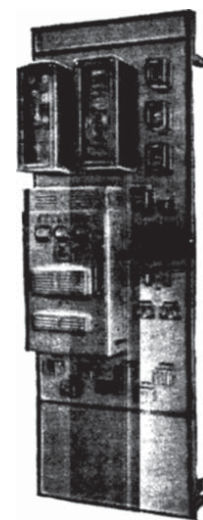
Рис. 4 Панель защиты ДФЗ-2 с приемопередатчиком ПВЗК
