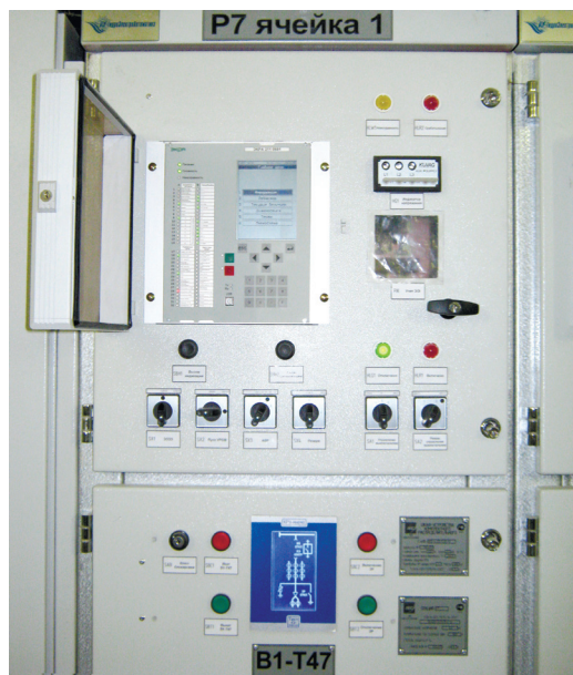
Фото 3. Терминал ЭКРА 211 0601 в ячейке С-410, установленной на секции Р7 КРУ 6 кВ Саяно-Шушенской ГЭС
