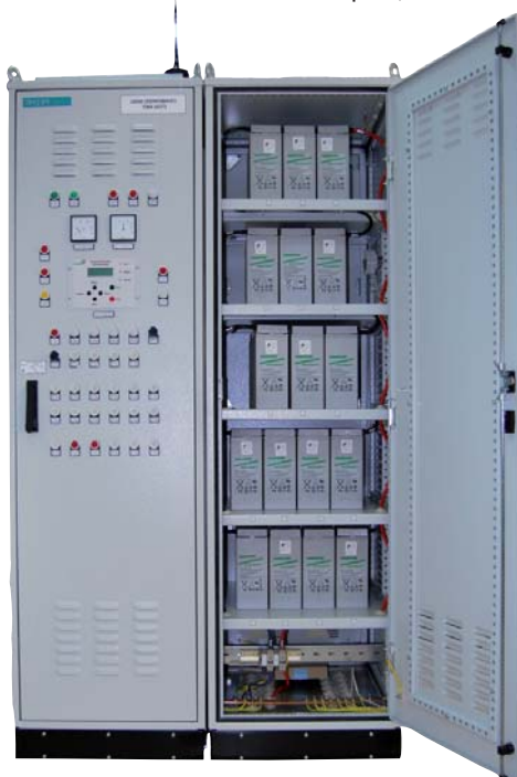
СОПТ типа ШОТЭ из двух шкафов — оперативного тока ШНЭ8003 и аккумуляторного ШНЭ 8004
