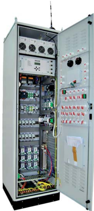
Шкаф ШНЭ 8003 с зарядно-питающими устройствами ЗПУ-10 и системой контроля изоляции ЭКРА-СКИ
