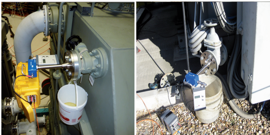
Рис. 14: Практическое применение СВЧ стробирования – СВЧ датчик на трансформаторе в лаборатории и в полевых условиях
