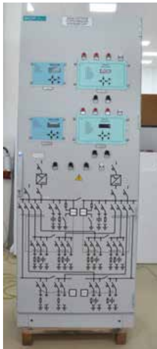
Рис. 5. Фото шкафа контроля изоляции с ЭКРА-СКИ
