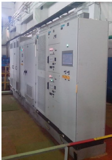
Рис. 4. Внешний вид системы частотного регулирования и шкафа управления автоматикой
