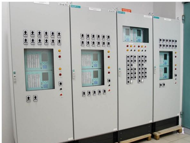
Шкафы РЗА станционного оборудования
