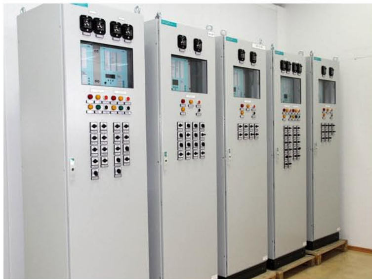
Шкафы РЗА подстанционного оборудования
