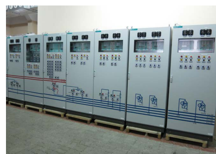
Рис. 5. Ряд шкафов ШМЭ с мнемосхемой подстанции
