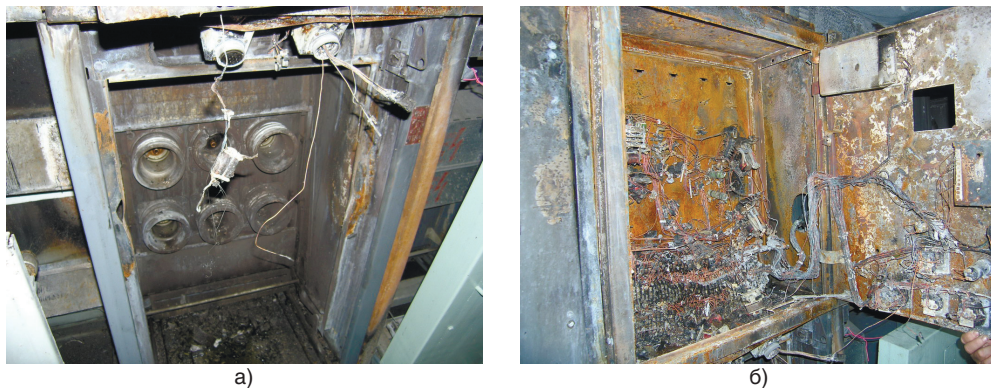
Рис. 1. Последствия дугового замыкания в ячейке КРУ-10кВ: а) масляные выключатели после дугового замыкания; б) релейный отсек КРУ.
