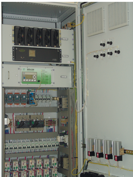
Рис. 12. Фотография шкафа распределения оперативного тока с системой контроля изоляции «ЭКРА-СКИ».
